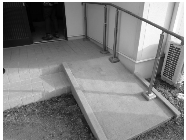
（2）グループホームの玄関に設置されているスロープ
